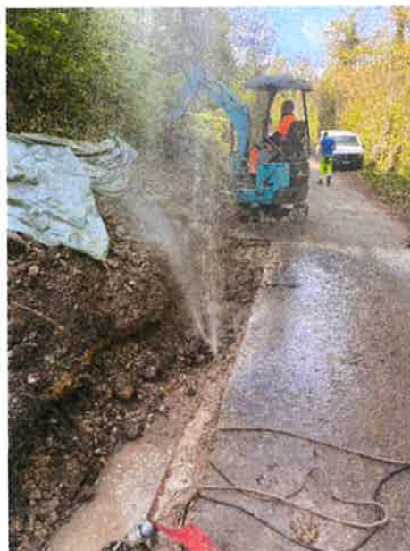
Fuite sur la conduite de la Bosse
