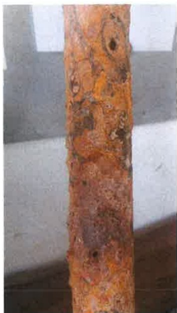
Etat de la conduite : nœux trous
