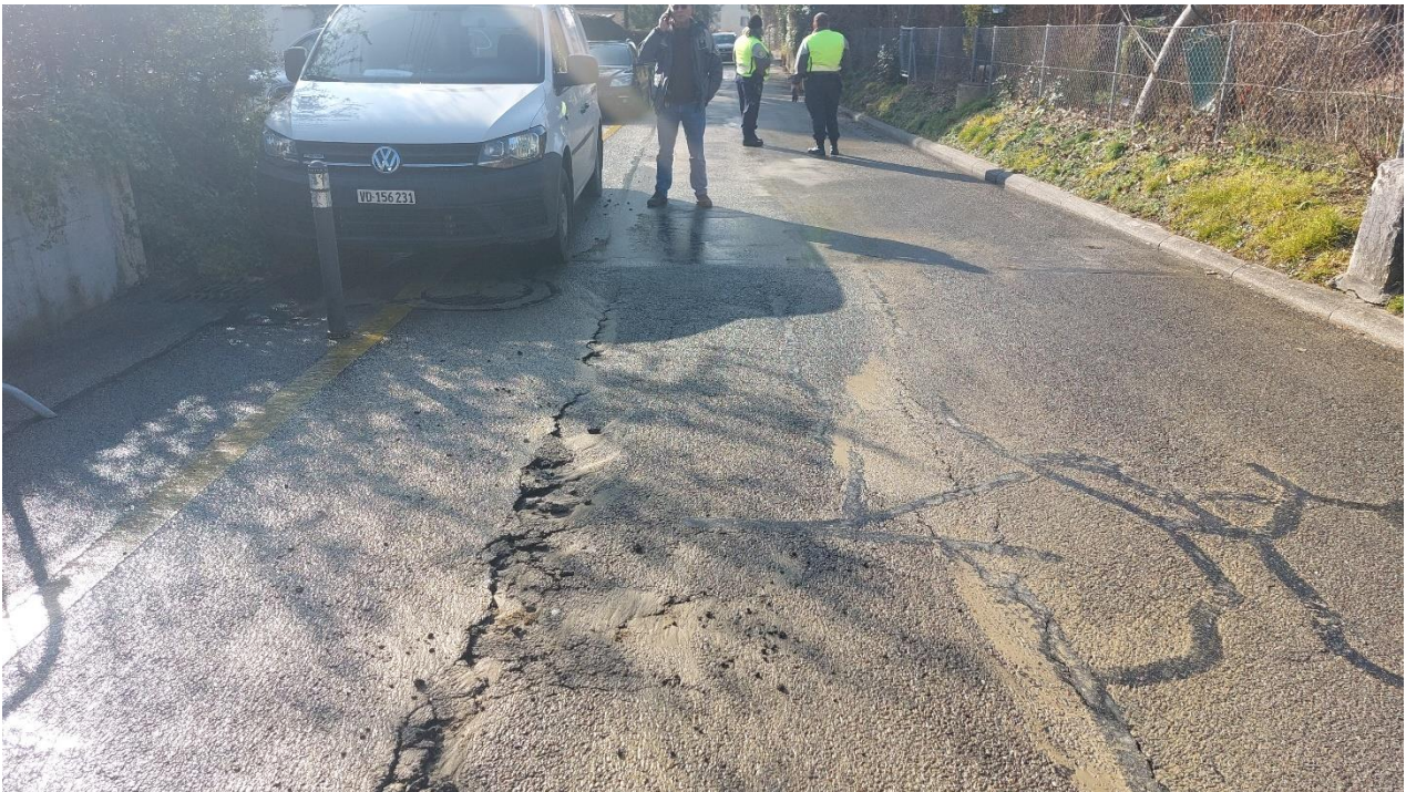
Dégâts provoqués sur la Route de l'Hôpital par la fuite
