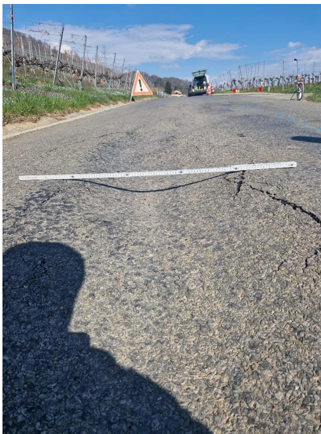
Déformation importante de la route du Pavillon
