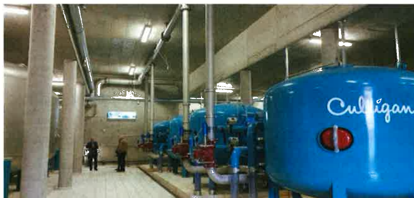
Station de traitement de Champ Jaillet
