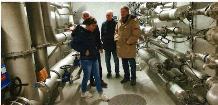
Réservoir Ouest à Bursins
